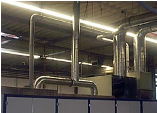
Die überschüssige Wärme der Anlage wird durch Luftkanäle in die Nachbarhalle geleitet und dort als Heizwärme genutzt.
